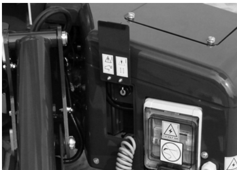
Fig. 116 Caja eléctrica interna en el compartimiento de los componentes eléctricos.
