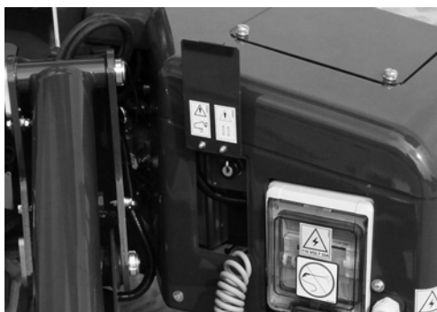
Fig. 127 Caja eléctrica interna en el compartimiento de los componentes eléctricos.
